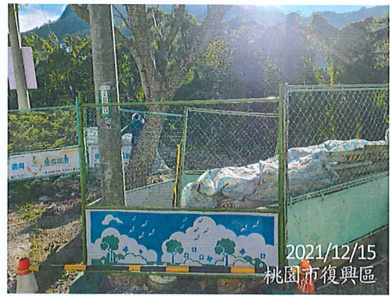
羅浮污水處理廠：
