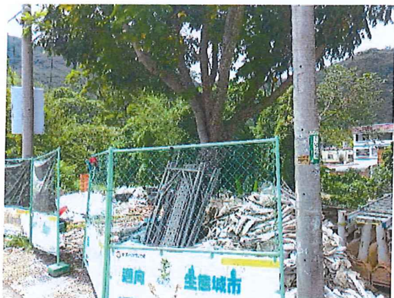
羅浮污水處理廠：
